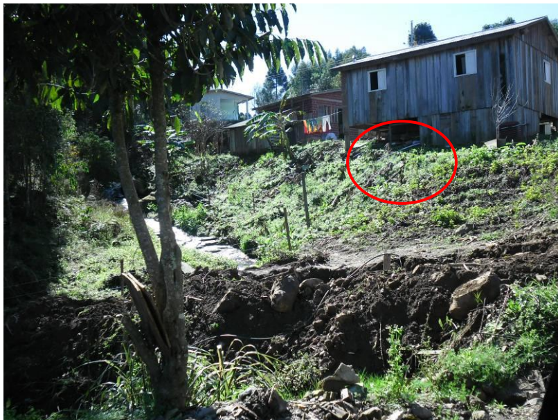
Figura 48 - Vista da forma de despejo direto do esgoto a céu aberto, com tubulação levemente enterrada
