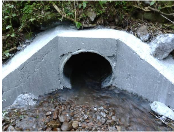
Figura 61 e 62 - Visualização de bueiros instalados junto a zona rural
