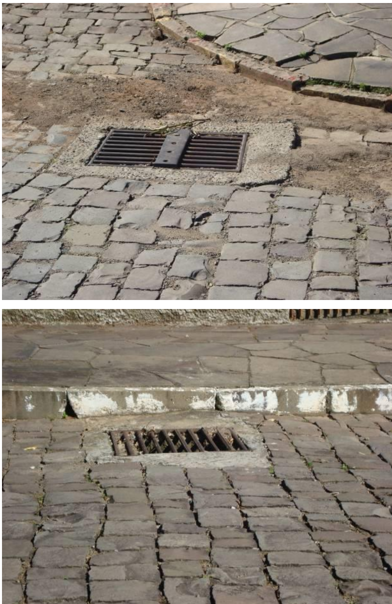
Figura 55 e 56 - Ilustração de pontos de drenagem bem localizados, em condições adequadas, contendo grelhas de retenção de sólidos
