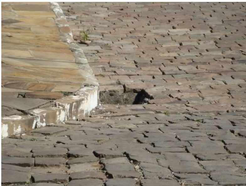
Figura 57 e 58 - Vista de duas situações não adequadas, contendo a tampa quebrada e canalização semisuperficial, com ferragens amostra
