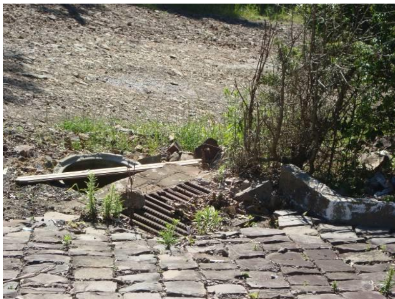
Figura 59 - Bueiro localizado em uma esquina, parte com pavimentação e parte sem pavimentação, com situação não regular
